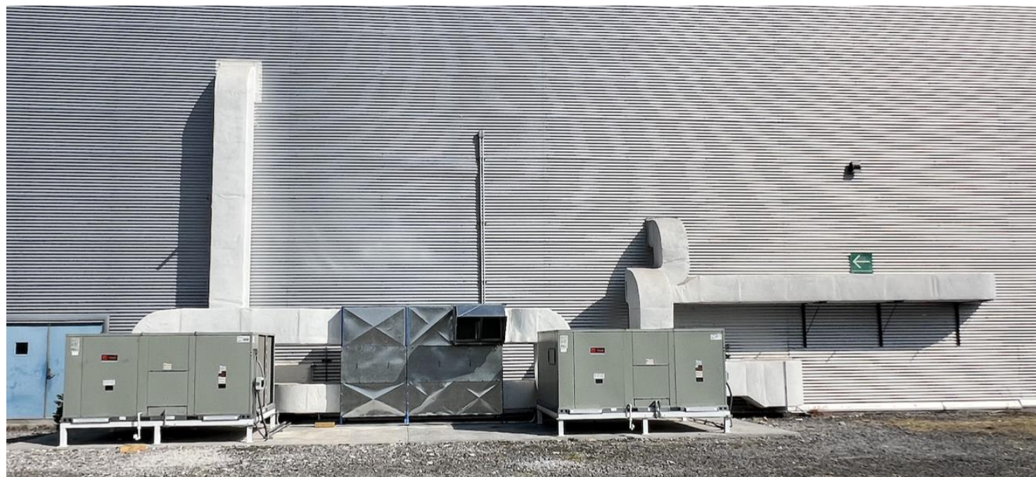
Ductos, controladores, filtros, Calidad de aire
